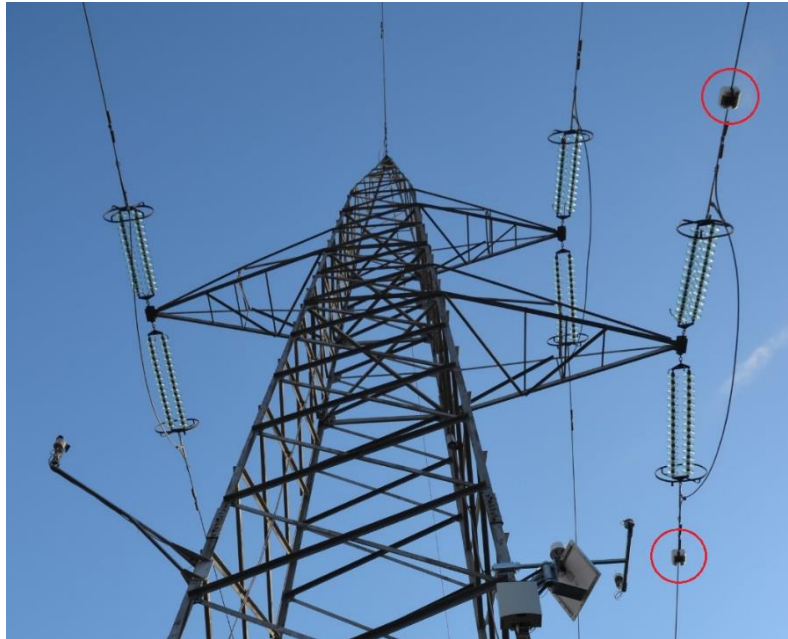
Slika 2.1.3. OTLM uređaj postavljen na dalekovodu [2]
